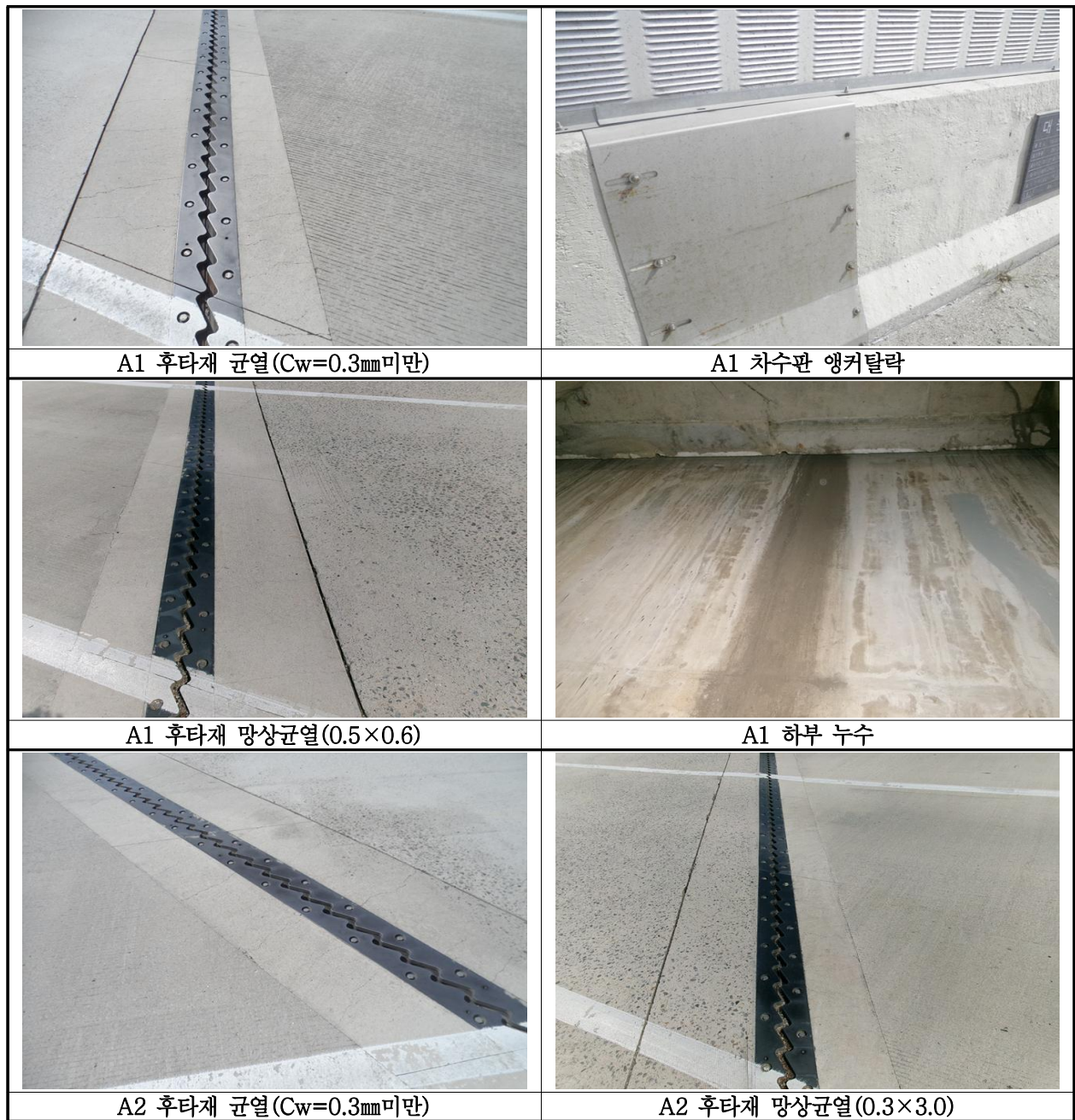
【사진 33.3.17】 신축이음장치 손상현황
