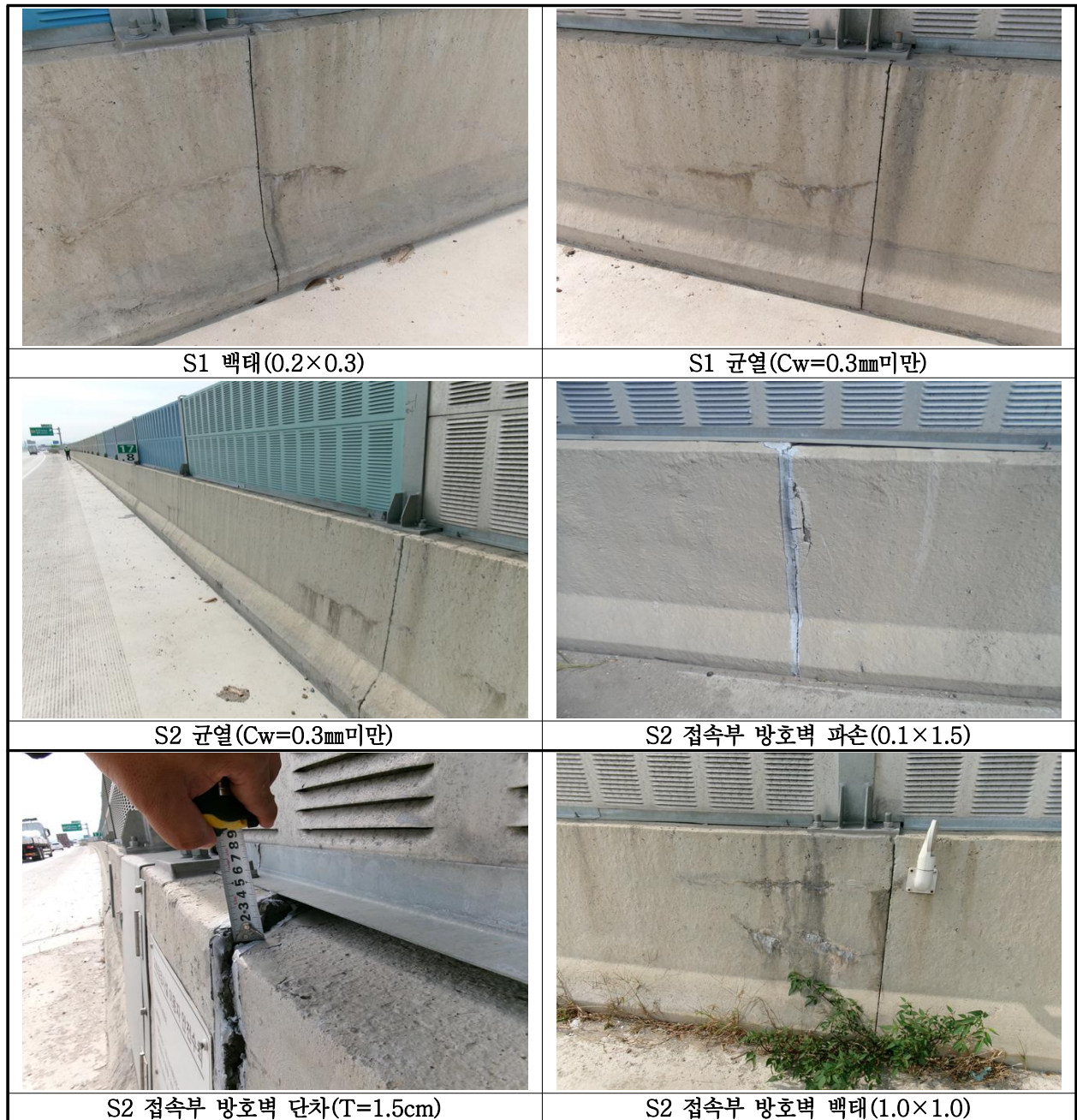
【사진 33.3.24】 방호벽 및 중앙분리대 손상현황
